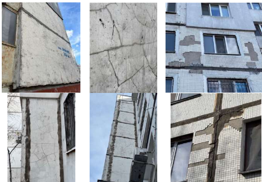
Figura 6. Degradarea fațadelor în urma acțiunii factorilor climatici
