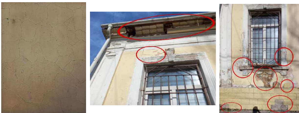
Figura 3. Degradările fațadei casei individuale
