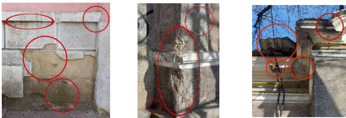
Figura 5. Degradările fațadei caselor de raport
