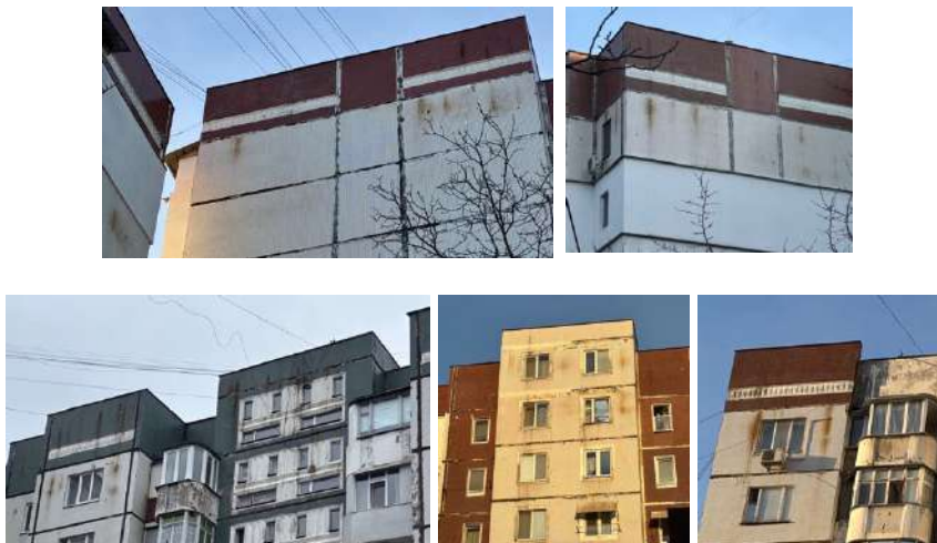
Figura 4. Exemple de degradări ale fațadelor
