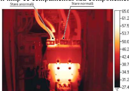
Figura 1. Semnalele termice ale echipamentelor de operare în condiții normale și anormale
